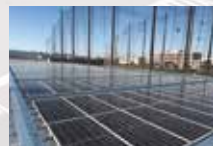
▲太陽光パネル
