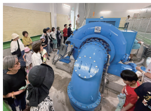
▲2025年6月2日に運転を開始した「COOP黒河川水力発電所」（小水力発電事業）
