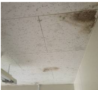
▲真っ黒なカビがはびこるキッチンの天井部。
