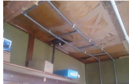
▲地震で壊れた天井。夏場はカビやヘッドロの臭いで健康被害も出ています。
