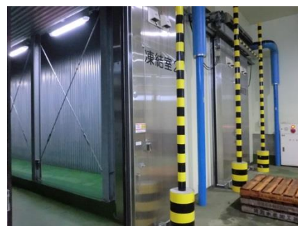
▲凍結室をはじめ立体自動冷蔵施設、自動製氷施設など最新の設備が整っています。
